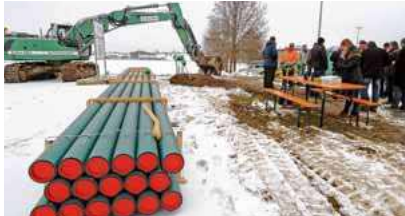
Eine sechs Kilometer lange Druckleitung wird die Gemeinden Muthmannshofen und Frauenzell ans Gruppenklärwerk des Abwasserverbands anschließen. Jetzt starteten die Bauarbeiten in Kimratshofen.
