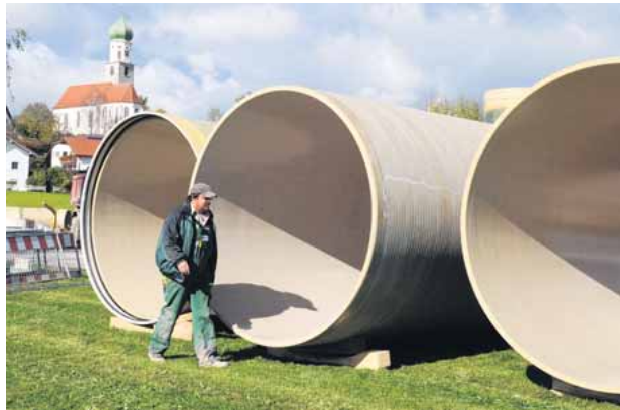
Gigantische Rohre werden verlegt, um Reicholzried mit dem Sammler in Dietmannsried zu verbinden. Mittlerweile hat sich auch die Frage der Finanzierung der Maßnahme zum Wohlgefallen von Dietmannsried gelöst. Foto: Hermann Ernst
